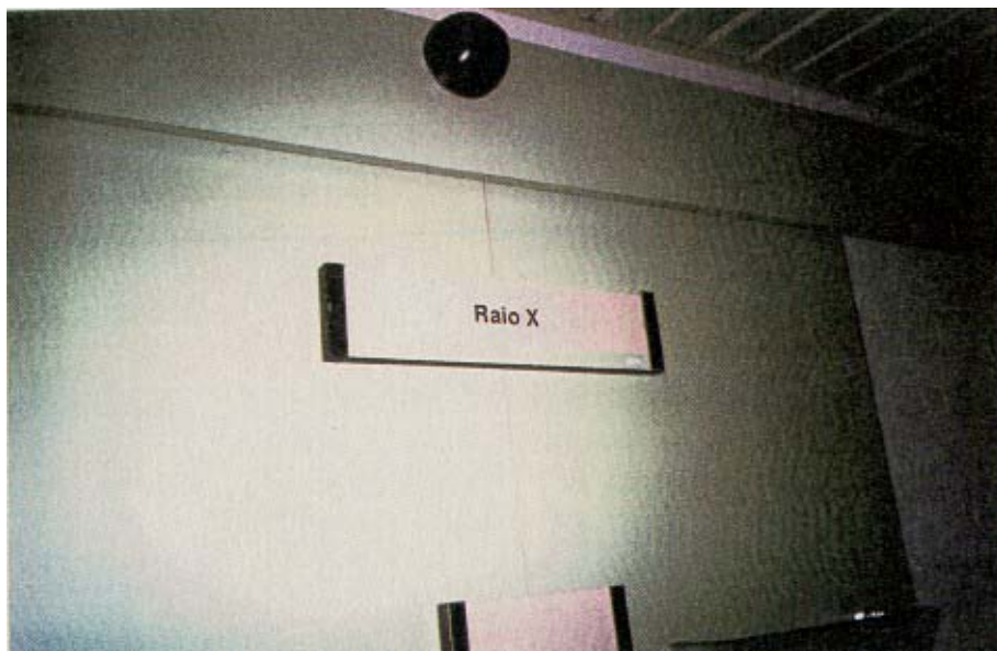
Foto 3 – Indicação dos Raios X com dispositivo luminoso acima da porta da sala de RX
