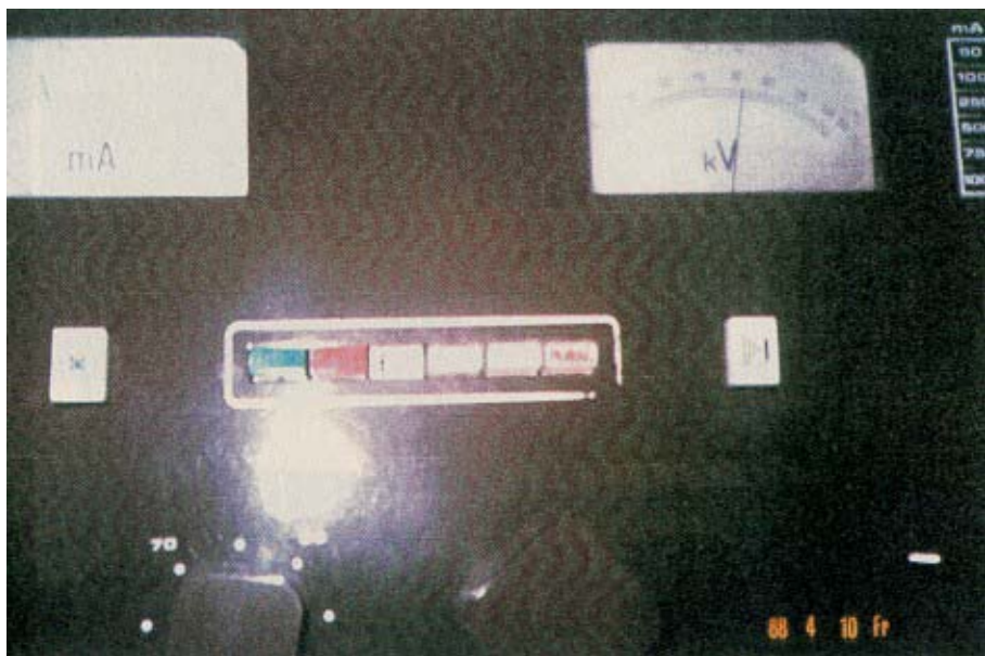
Foto 7 – Pannel de comando do equipamento de Raios X com comando quebrado (3º botão da esquerda para direita)
