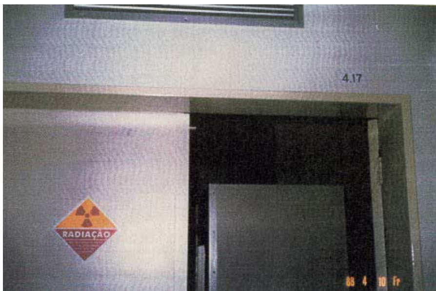
Foto 4 – Sinalização da radiação na porta da sala de RX
